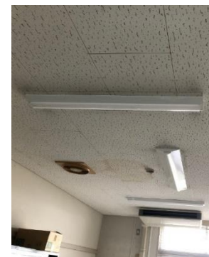
教育学部校舎本館棟研究室 LED器具（改修後）
