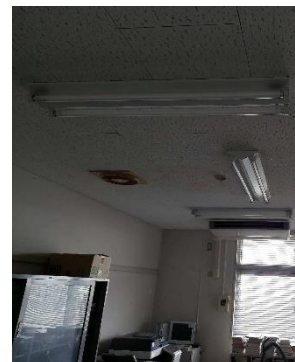
教育学部校舎本館棟研究室 蛍光灯（改修前）
